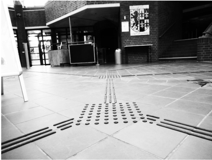
Das neue "taktile Leitsystem" für Sehbehinderte im Foyer des Bürgerhauses. Foto: hk
