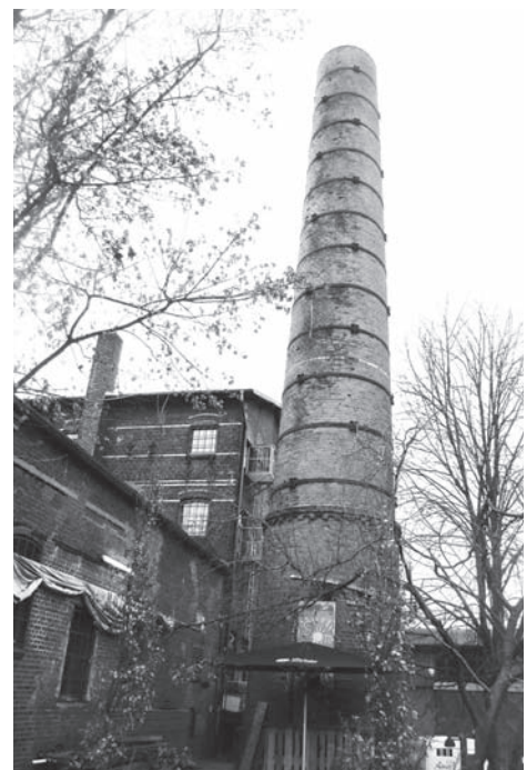
Auch der Schornstein, das umsturzgefährdete Wahrzeichen der Hofa, wird restauriert. Foto: hk
