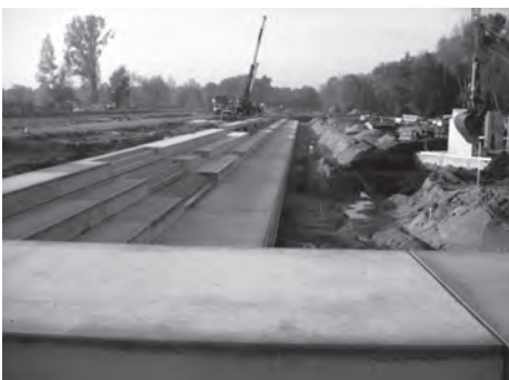
Der LSBG baut hier, nach eigener Aussage, einen Kanal in „uralter, bewährter“ Tradition der Wasserwirtschaft“.
