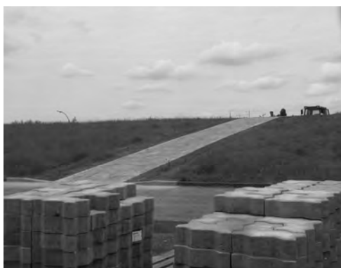
Jetzt ist der Übergang über den Deich an der Hafensrandstraße fast fertig.
